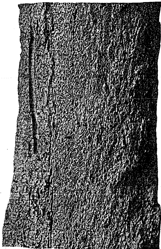
Fig. 196. Et Stykke af en stor Pæl fra Frederikshavns gamle Havn. Talrige Gange af Pælekrebs ses; tilvenstre en Gang af en Pæleorm, blottet ved Pælekrebseens Arbejde. \frac{1}{4} 1).
